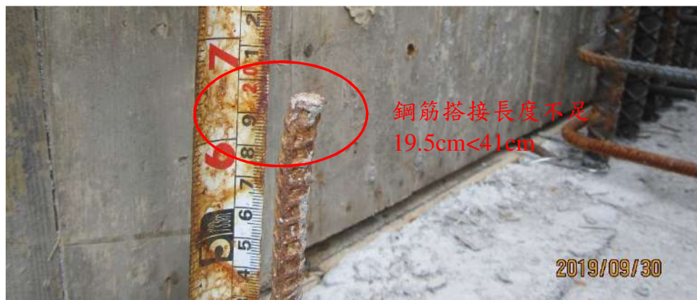
圖 2-17、鋼筋搭接長度不足
