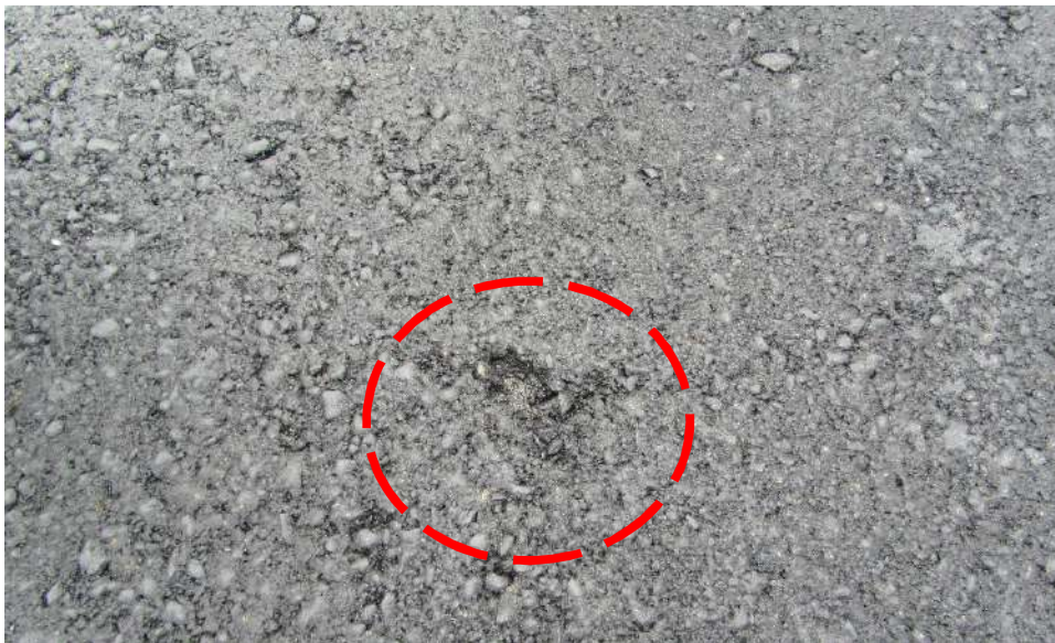
圖 2-38、瀝青混凝土用料不足、粒料分離(1)
