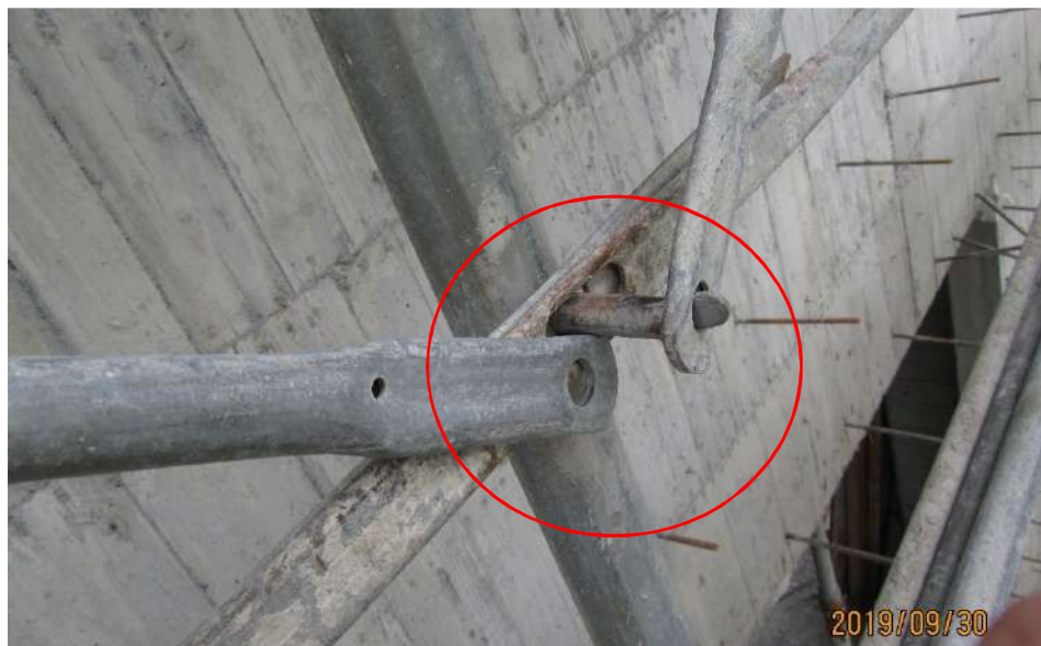
圖 2-52、施工架交叉拉桿固定未確實
