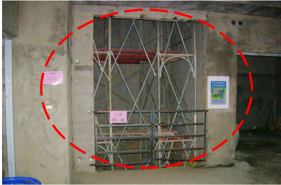
圖 2-45、電梯間開口處設置欄杆與警語
