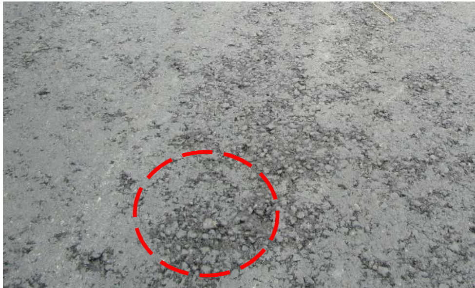
圖 2-40、瀝青混凝土用料不足、粒料分離(3)
