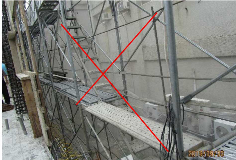
圖 2-51、施工架部份未設置交叉拉桿
