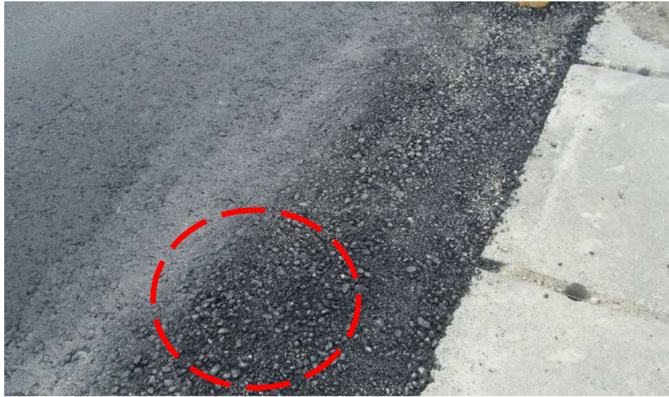
圖 2-39、瀝青混凝土用料不足、粒料分離(2)
